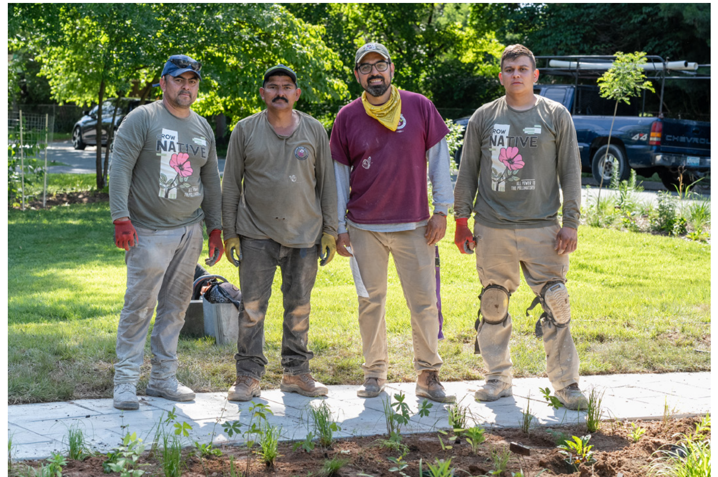
Los trabajadores propietarios de la Cooperativa Swamp Rose instalan una pasarela y un jardín de plantas nativas.
